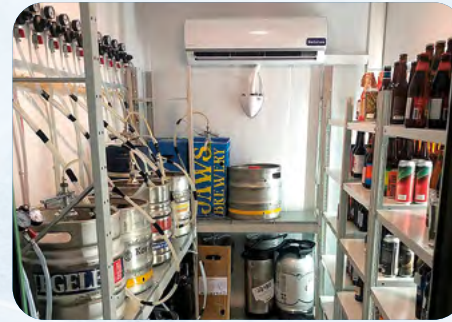
КАМЕРА ДЛЯ ПИВА ПОД КЛЮЧ г. Санкт-Петербург
